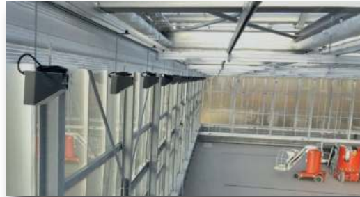
Montage vor Ort
