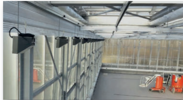
Montage vor Ort
